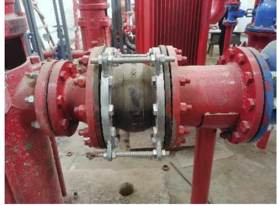
水泵与管道采取软性连接降噪
