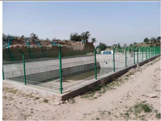
初期雨水收集池
