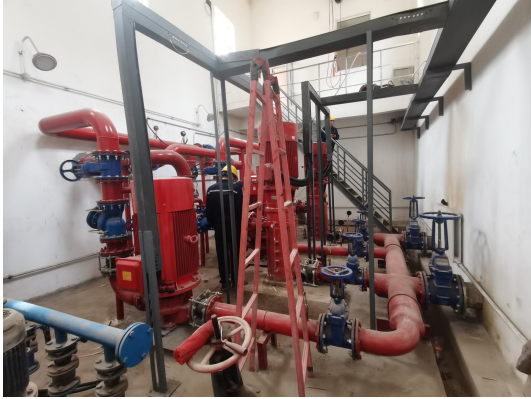
水泵高噪声设备室内安置
